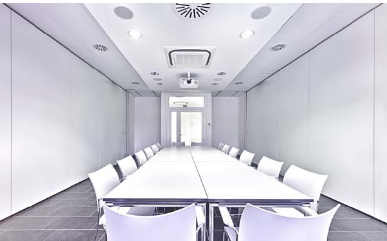
Besprechungsraum: Zwischendeckengerät vierseitig ausblasend
